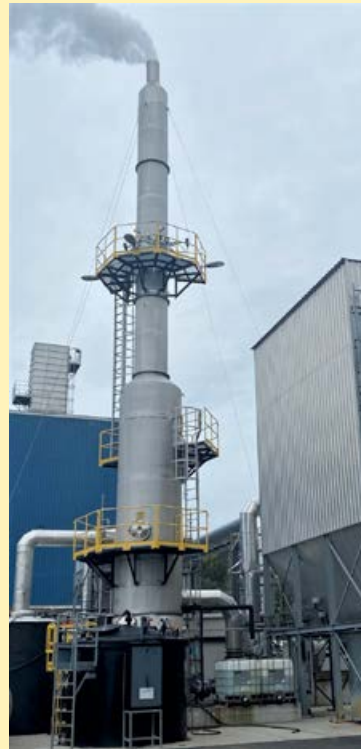
Svovelscrubber tilknyttet pilotanlegget hos Fiven.
