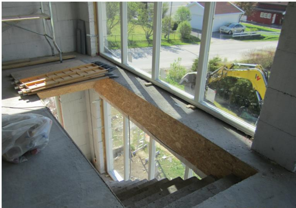
Arbeid på nærmere 250 byggeplasser ble stanset i storaksjon i mai. Denne byggeplassen hadde åpent trappeløp. Foto: Arbeidstilsynet
